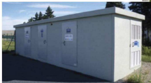
Poste de transformation
